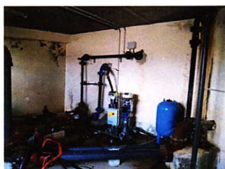
La salle avec les pompes.
